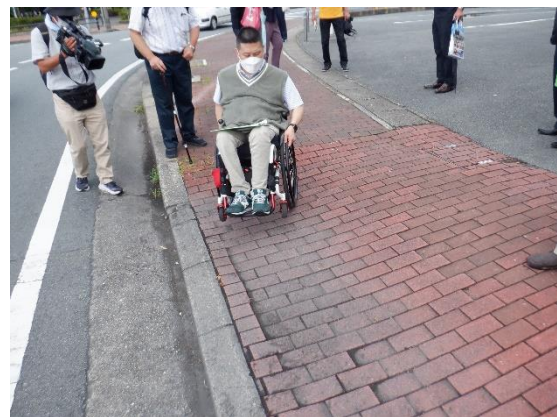
歩道（伊勢南島線） 凸凹、ブロックの隙間、ひび割れなどが生じ ている。
