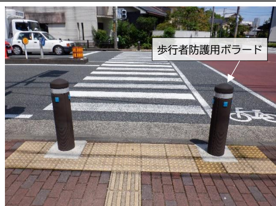
歩道（伊勢磯部線：県-17） 歩行者防護用ポラードが視覚障がい者誘導 用ブロックに食い込んで設置されている。
